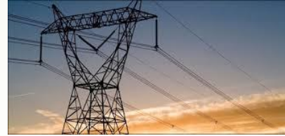
Ligne à haute tension
